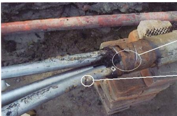
Рис.4: Коррозия внешней оболочки и точечная сквозная коррозия свинца
