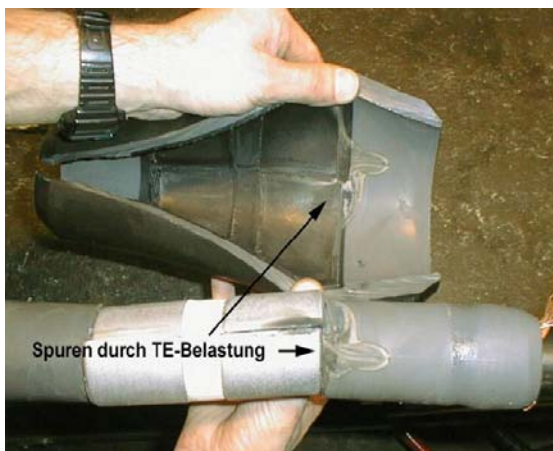
Рис. 7: Повреждения частичными разрядами неправильно смонтированной муфты путем заталкивания
